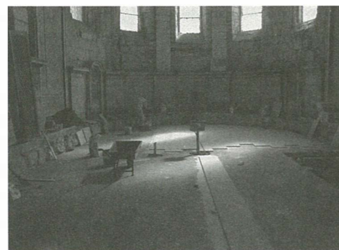
Figs. 45 e 46 Obras de preparação do Carmo para impacte das novas linhas de metropolitano, 2000.
