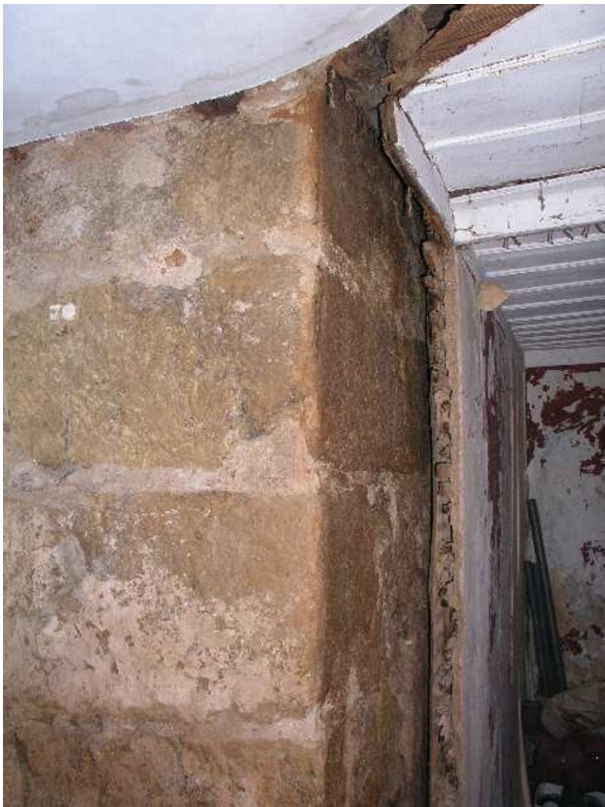
Figura 6 – Perspetiva do cunhal e silhares postos a descoberto após retiro de taipas de fasquio.
