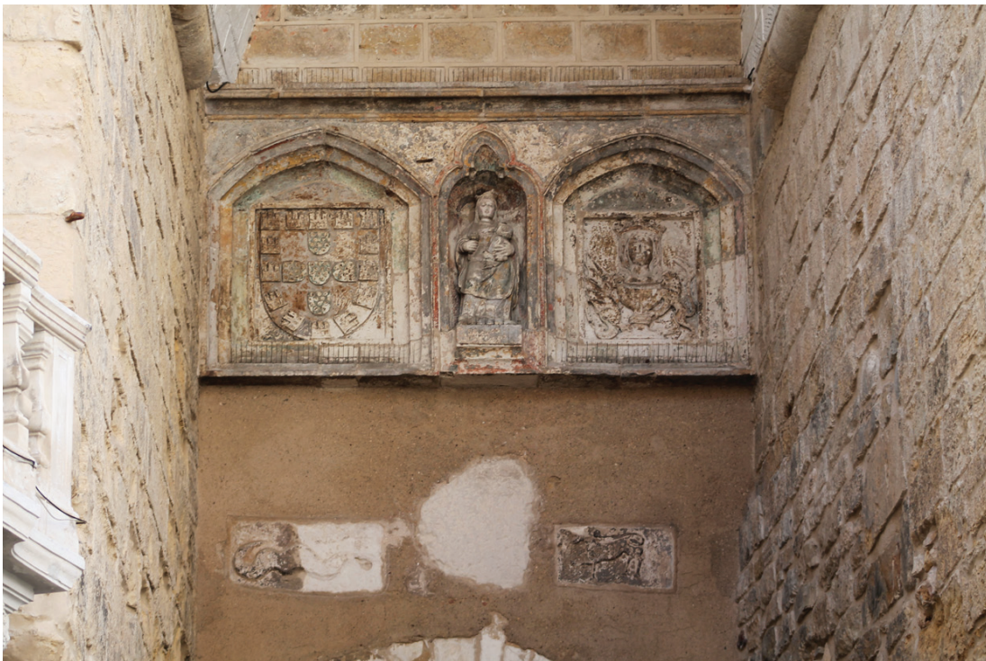
Figura 9 – Pormenor dos painéis escultóricos na parede de fundo da entrada da torre.
