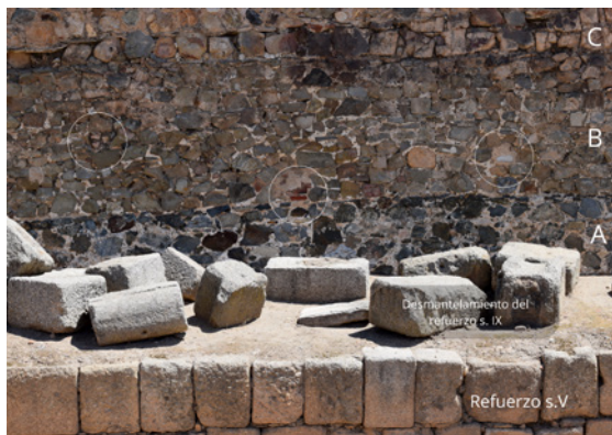
Figura 10 – Tres tongadas visibles en el paramento augusteo (última hilada de restauración) con diferentes tipos de piedra, gasto en la cantidad de cal y formas de colocarlas. Restauraciones en el paramento indicadas con círculos. Por delante, el refuerzo del siglo V (foto M. Alba).
