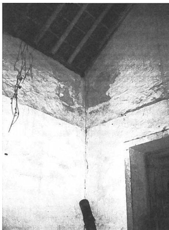
Fig. 21 e 22 Fendilhação provocada pela acção da água no interior das paredes. Fonte: Arquivo pessoal Luis Corredoura.
