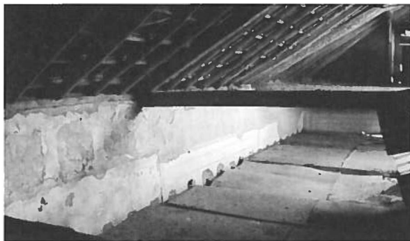
Fig. 23 Antigo revestimento do intradorso das paredes estruturantes visível ao nível da cobertura. Repare-se no pormenor da estrutura do tecto falso, que foi colocada de uma forma que não teve em atenção o tipo de revestimento existente nessas paredes. O lintel, que corre ao longo desta parede, foi construído em tempos mais recentes. Fonte: Arquivo pessoal Luís Corredoura.
