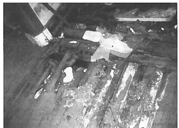
Fig. 17 Estado de degradação do pavimento de madeira do piso principal provocado por acção de fungos de podridão associados à existência de água no interior do edifício. Fonte: Arquivo pessoal Luís Corredoura.
